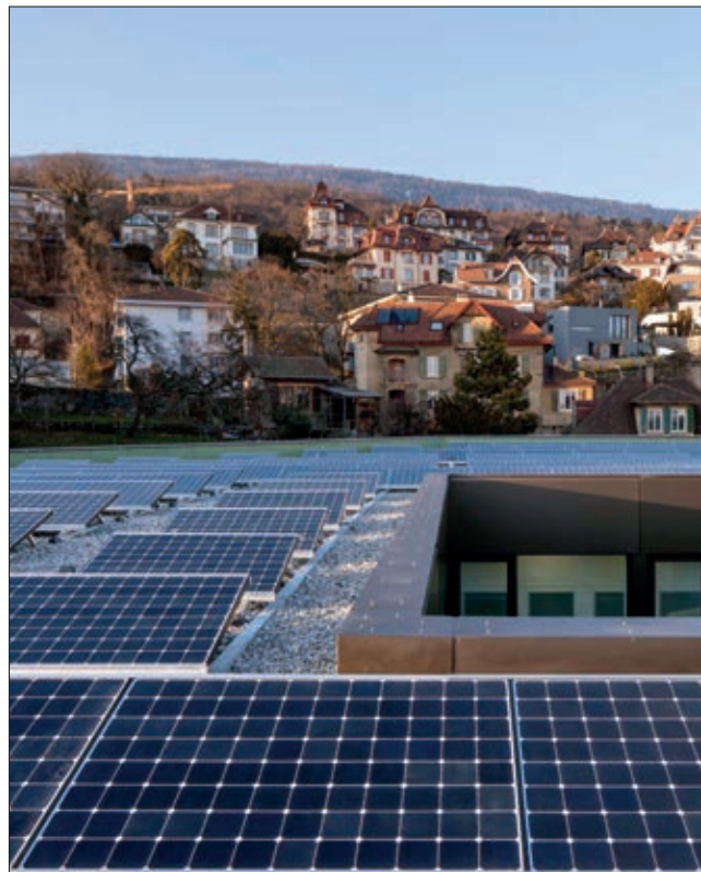
Centrale photovoltaïque installée sur la toiture du bâtiment Microcity, dont la réalisation par Viteos permet de fournir 224'500 kWh par année au réseau électrique de la ville, soit l'équivalent de la consommation d'environ 64 ménages. PHOTO YVES ANDRÉ
